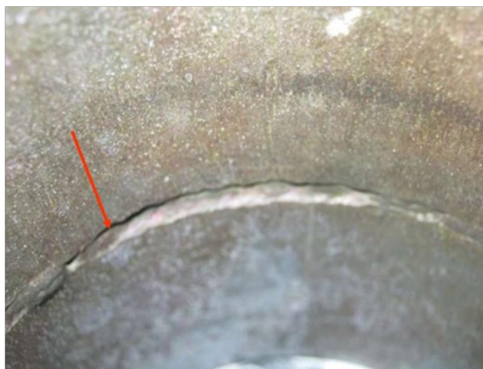
Рисунок 2.4. Непровар сварного шва
