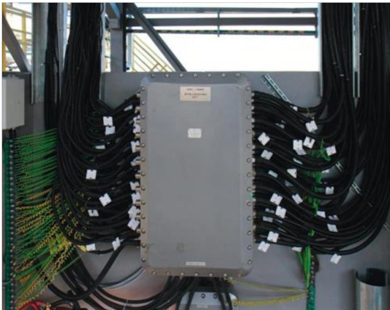
Рисунок 2 – Размещение контроллеров внутри взрывозащищенного шкафа непосредственно на сливноналивной эстакаде
